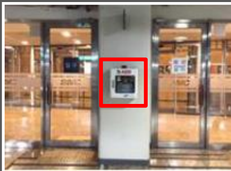
암병원B5주차장 (유리문 옆 기둥)
